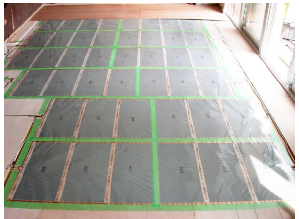
ヒーターの周囲へ配線溝を工作した例です。
